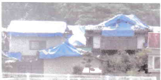
(資料写真 地震後のアール・シエール屋根)
